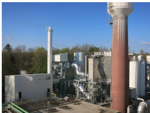
Abbildung 2: Fernwärmanlage; Quelle: Saint-Gobain Oberland AG
