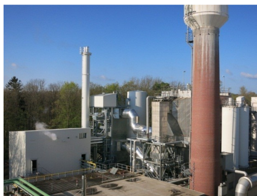
Abbildung 2: Fernwärmanlage; Quelle: Saint-Gobain Oberland AG
